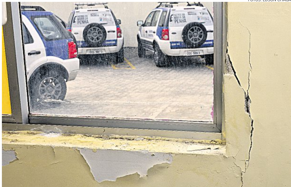
Rachaduras, trincas e infiltrações podem ser vistas em várias paredes do imóvel, condenado pelo município
