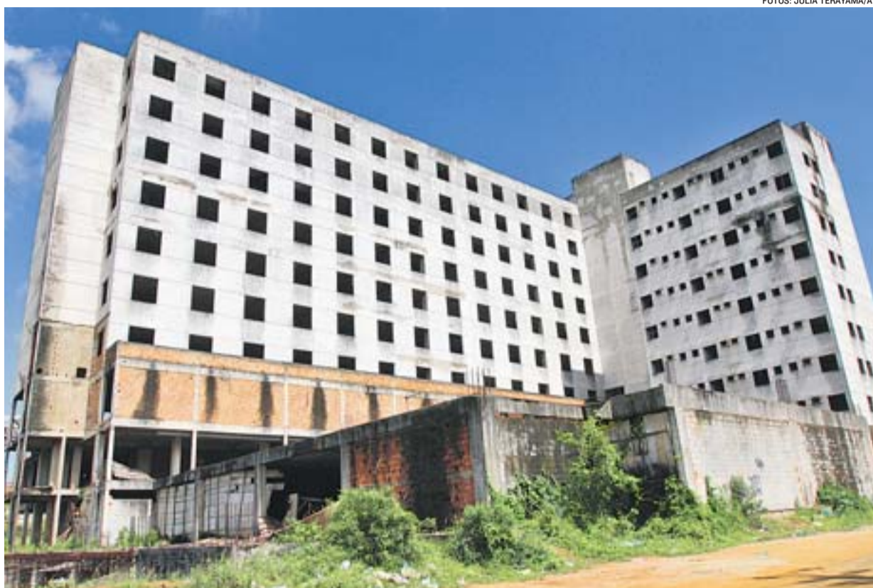
CONSTRUÇÃO foi abandonada e agora será desapropriada para dar lugar ao Hospital-Geral de Cariacica
