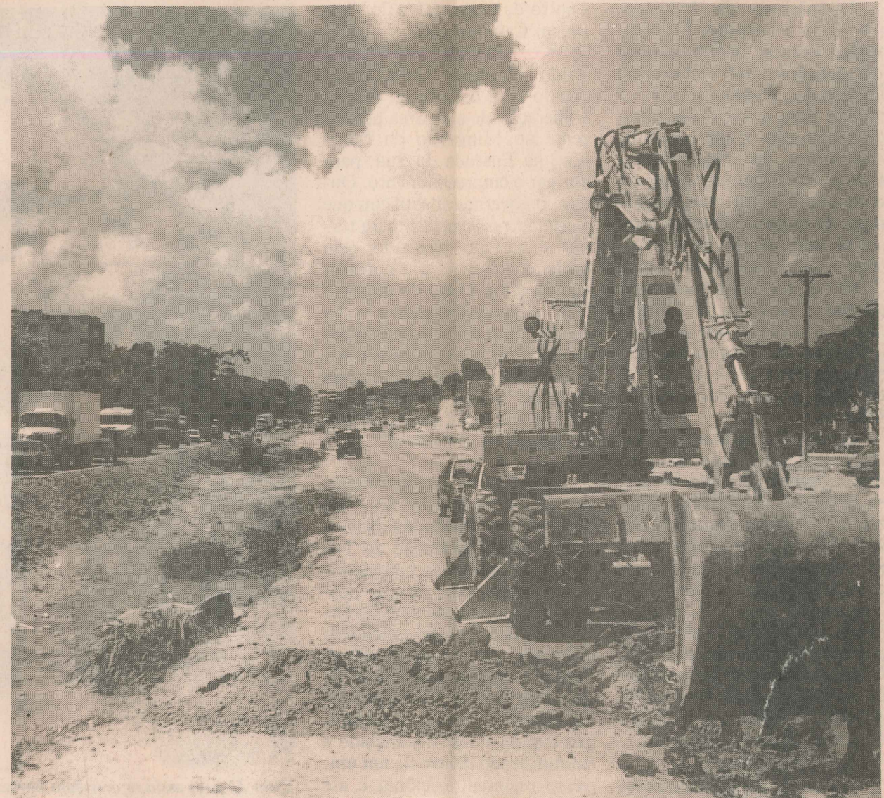
A Tracomal foi autorizada a construir rede de água pluvial num trecho de 500 metros com bueiro tubular
