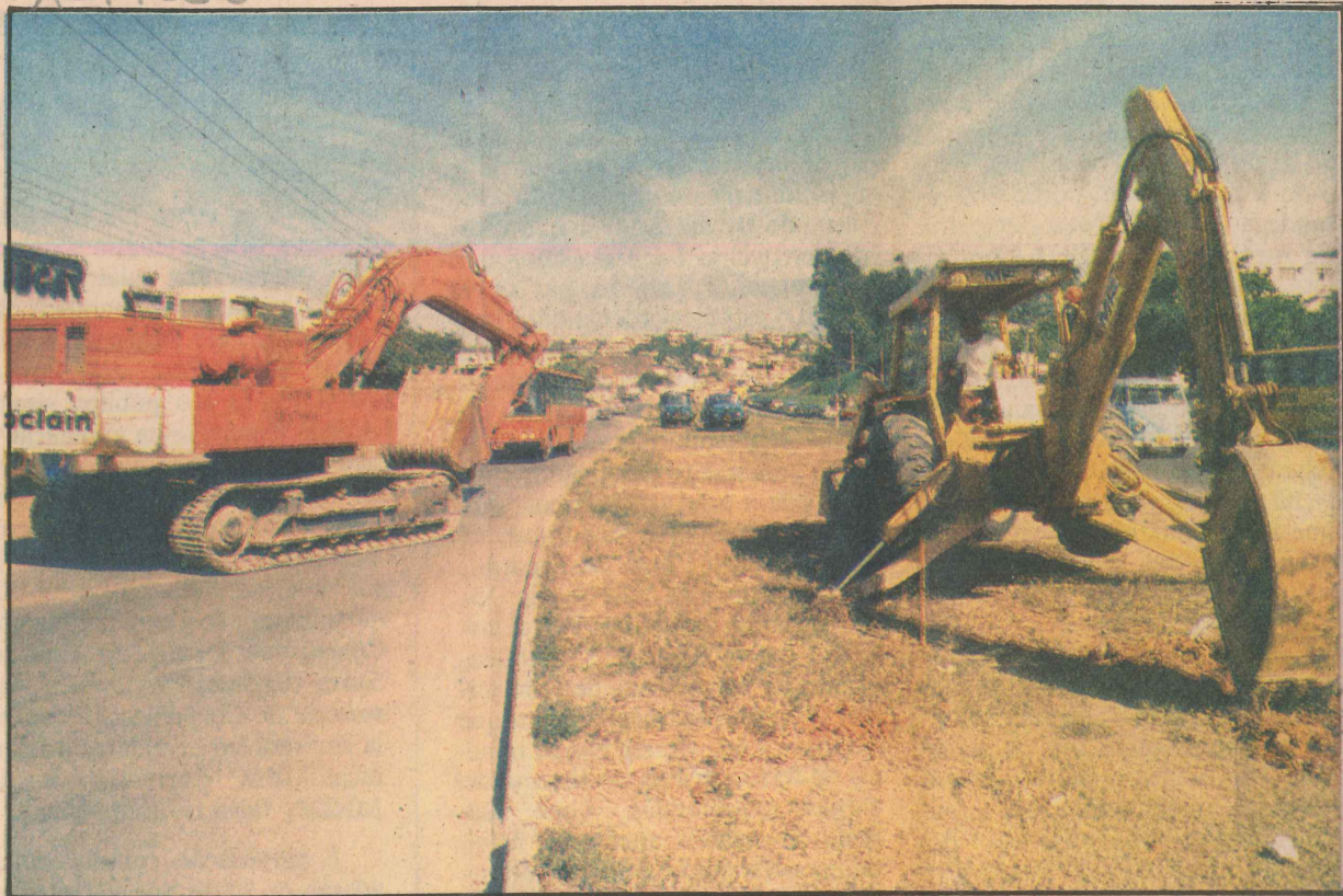
Em uma extensão de 4,2 quilômetros, entre Alto Lage e o Ceasa, serão construídas passarelas e ciclovias
