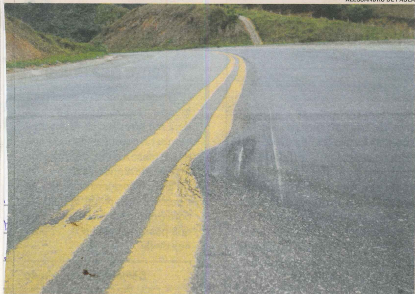
UM DOS TRECHOS da rodovia em que aparece desnível na pista
