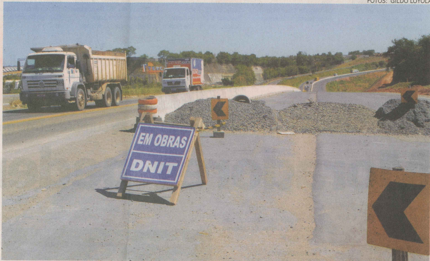
CONSTATAÇÃO. Na Rodovia do Contorno, há vários pontos de intervenção, mas poucos trabalhadores executando as obras
