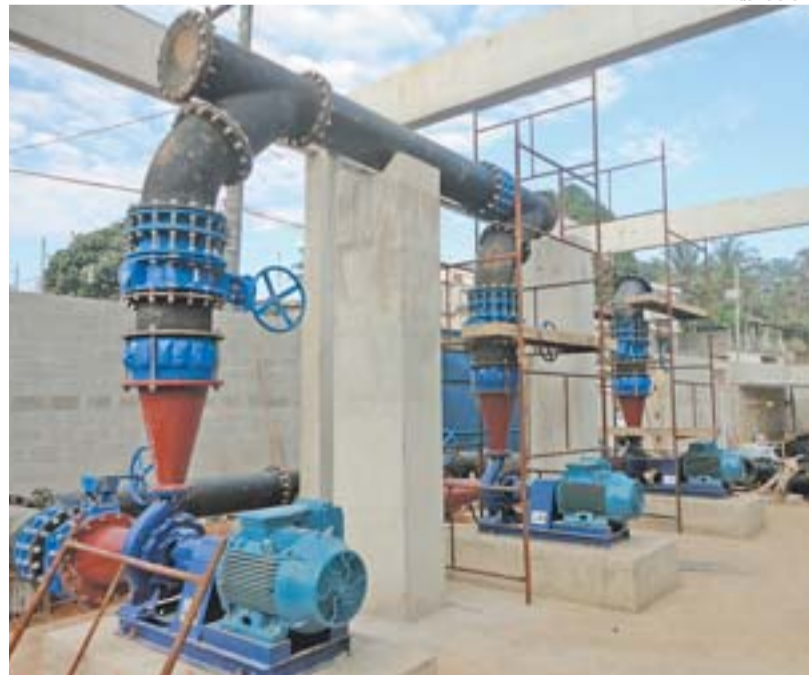
RESERVATÓRIO DE ARAQUÉM: 2,7 milhões de litros de água armazenados
