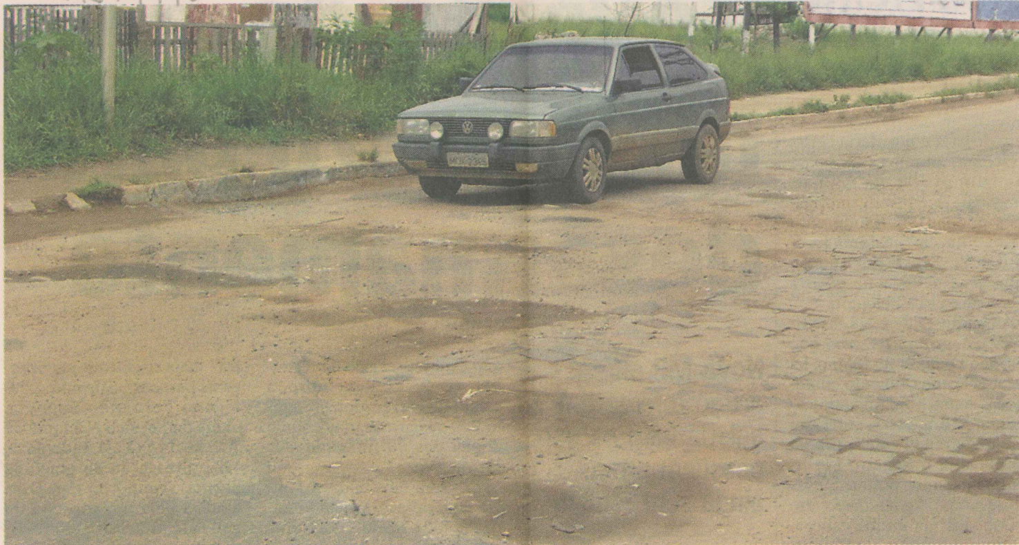
SEM SAÍDA. Um dos buracos no trecho da ponte está colocando em risco a vida de motoristas e pedestres. FOTO: KARLLA HOFFMANN
