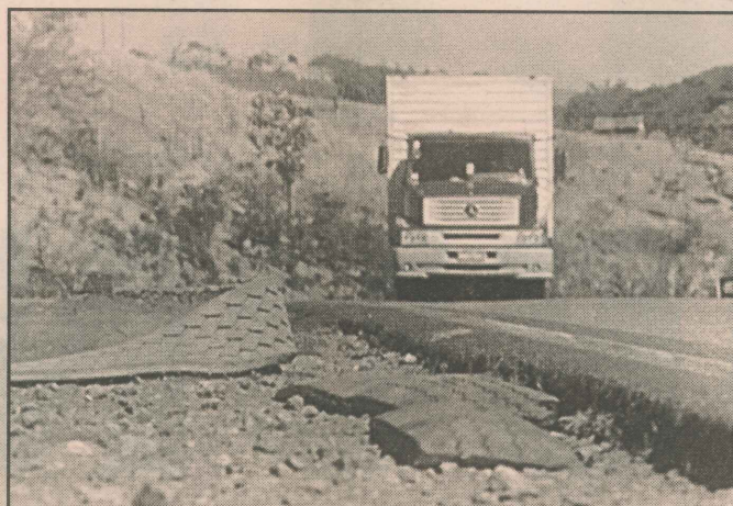
No quilômetro 198 da BR-101 Norte, na altura de João Neiva, o acostamento é tão desnivelado que danifica os pneus dos caminhões. Ao passar pelo acostamento, recapagens de pneus caem e ficam espalhadas pelo asfalto
