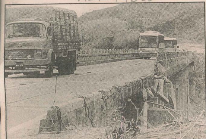
Os muros da ponte do quilômetro 208 da BR-101 Norte, em Monte Seco, foram destruídos. Qualquer fechada ou ultrapassagem indevida pode ser fatal. O local é considerado pelos caminhoneiros como um dos trechos mais perigosos
