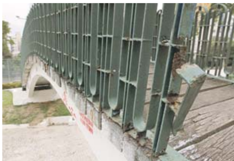
EMBORA SEJA VISÍVEL que a praça do Cauê passou por manutenção recentemente, há problemas, principalmente na ponte, com um ferro saliente na grade.
