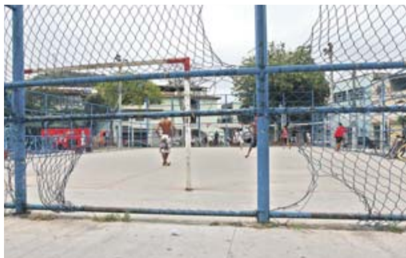
RACHADURAS no chão da praça da Glória colocam em risco quem pratica patins e skate. Na quadra, a grade de proteção está solta, com diversos buracos.
