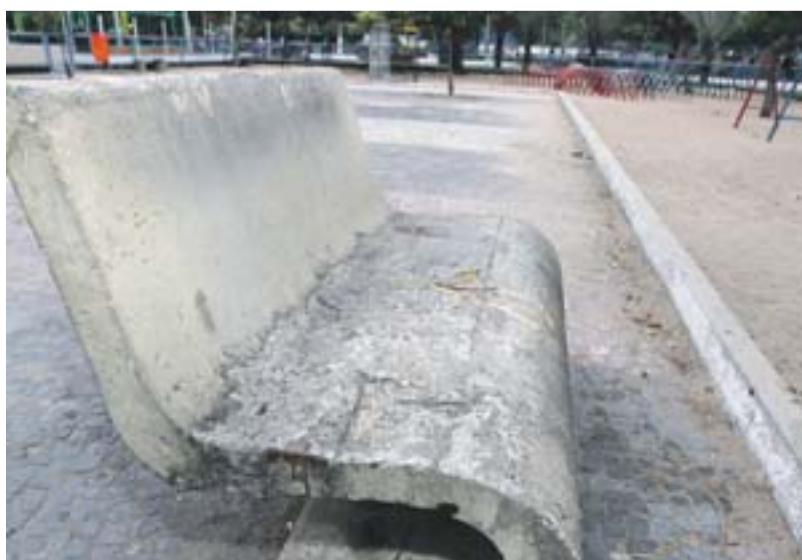
NA PRAÇA DOS NAMORADOS , na Praia do Canto, em Vitória, um balanço e um banco estão quebrados, com ferros expostos, e há lixo na areia.
