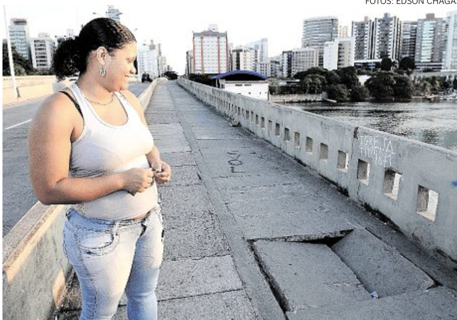
Leidimara dos Reis diz que, além do buraco, há outros sinais de desgaste na ponte
