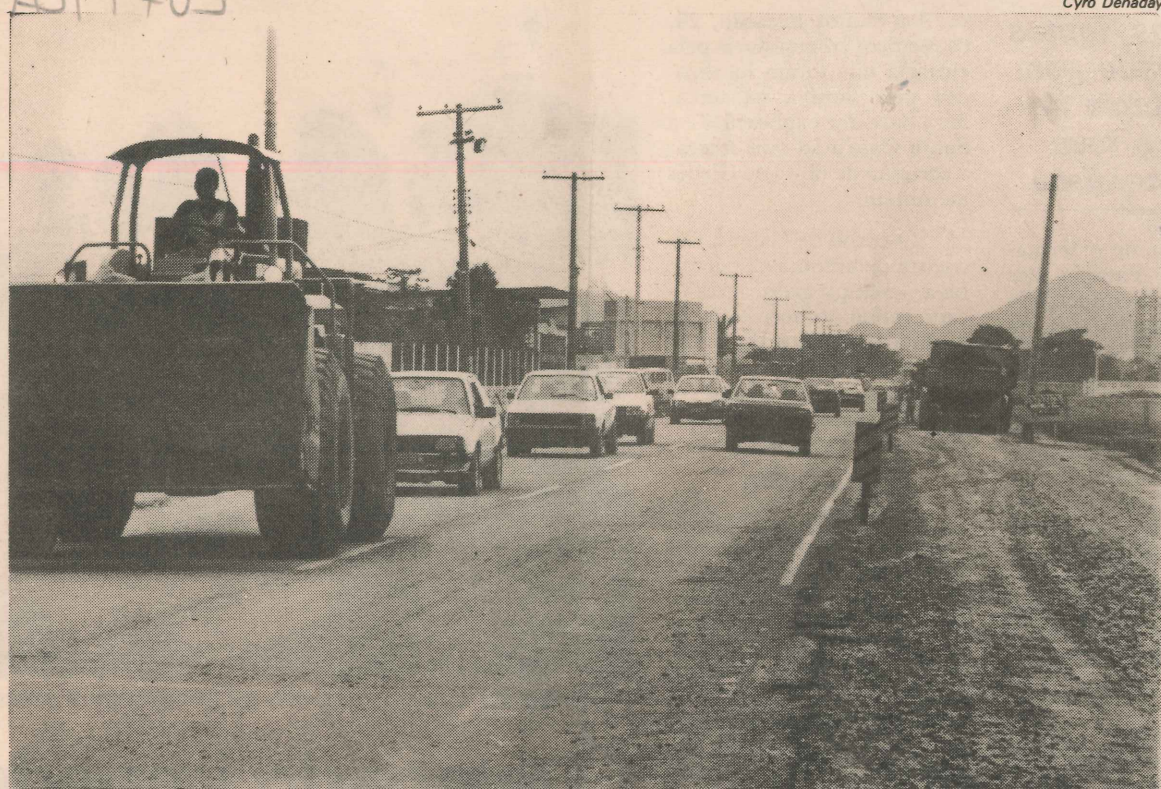
A Rodovia do Sol é uma das estradas que tiveram as obras de recuperação suspensas
