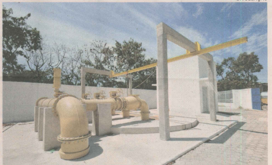
Foram criados 8km de redes de esgoto até a Estação de Tratamento Mulembá
