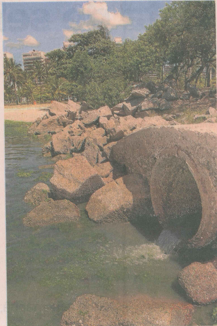
CONTAMINAÇÃO. Próximo à Ilha do Frade, é possível ver manilhas lançando no mar água visivelmente contaminada
