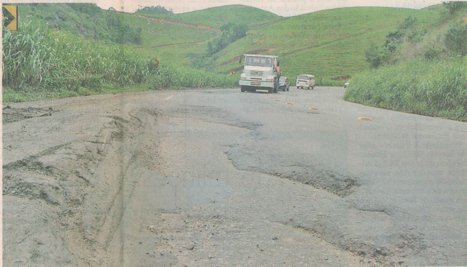
MÁ CONSERVAÇÃO. Embora parte dos recursos recebidos pelo Estado seja para melhorias em obras públicas, o valor não é suficiente para a ampla recuperação de estradas federais, como neste trecho da BR 101 Norte. FOTO: ALAN RODRIGUES
