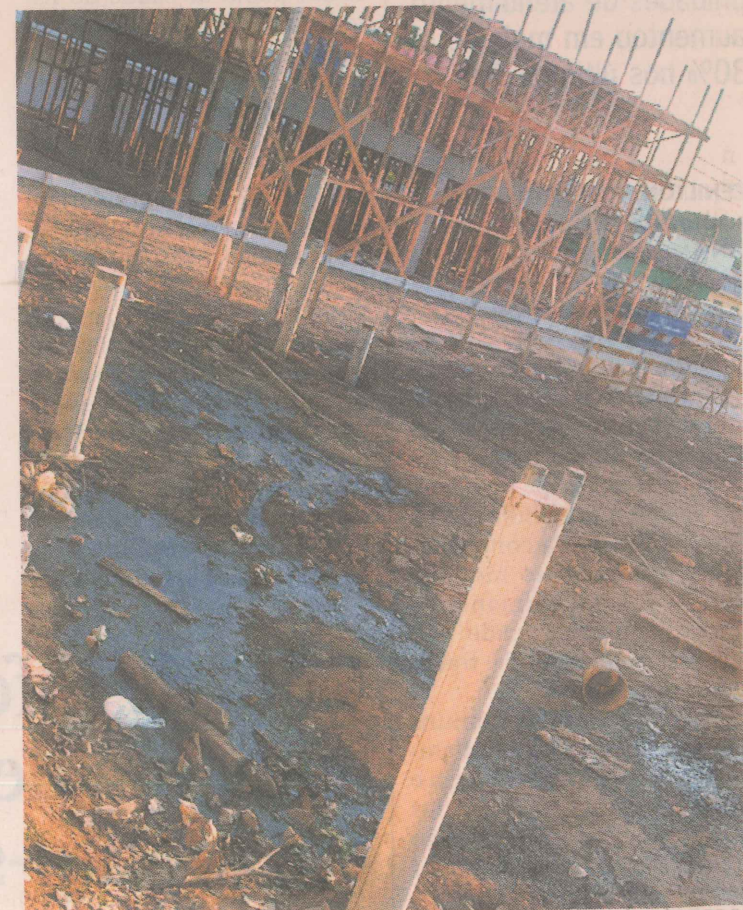
FOCOS. Moradores apontam obra de escola como um dos locais onde há a proliferação do mosquito da dengue no bairro. FOTO: GUSTAVO LOUZADA
