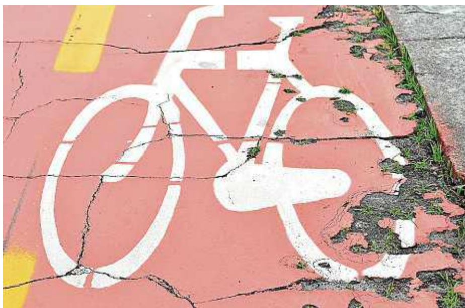
As rachaduras e os buracos se repetem por 30 metros ao longo da ciclovia
