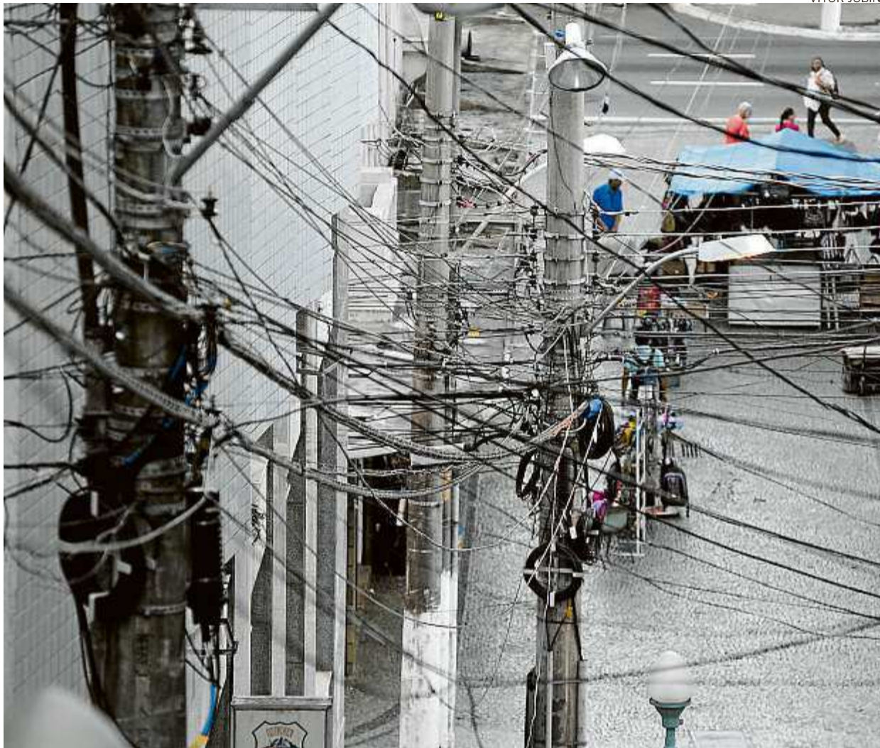
Da Escadaria Maria Ortiz, no Centro de Vitória, é possível verificar a poluição visual causada pelos fios
