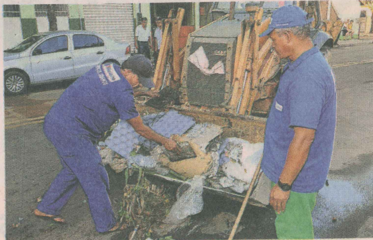
IMPROVISO. Homens trabalhavam sem botas ou luvas adequadas
