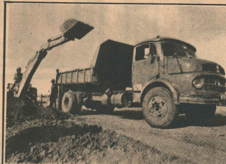
1º) No "Pontal do Ipiranga" as obras de urbanização estão em ritmo acelerado água, luz, aterro, meio-fio etc., realizados pela Tertran (Terraplanagens e Construções Ltda - Av. Amazonas 135 - 5º andar - BH).
