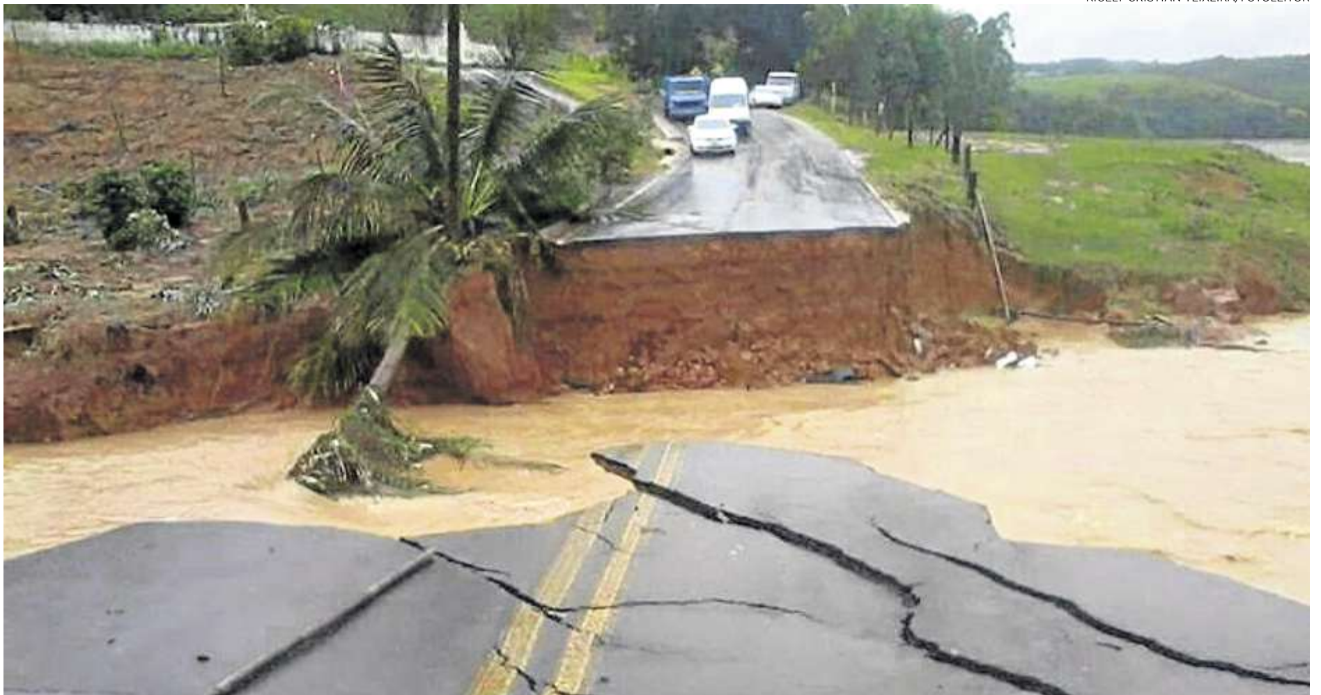
A força do rio que corta a cidade deixou um rastro de destruição, mas a prioridade do município é o socorro aos cerca de 250 moradores desabrigados
