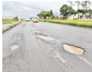
DARLY SANTOS: buracos na pista
