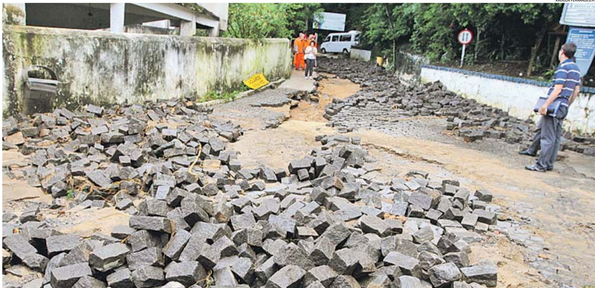
PARALELÉPÍPEDOS DA LADEIRA DO CONVENTO DA PENHA foram arrancados pela força da água da chuva. Funcionários do DER-ES iniciaram ontem a recuperação para reabertura do acesso
