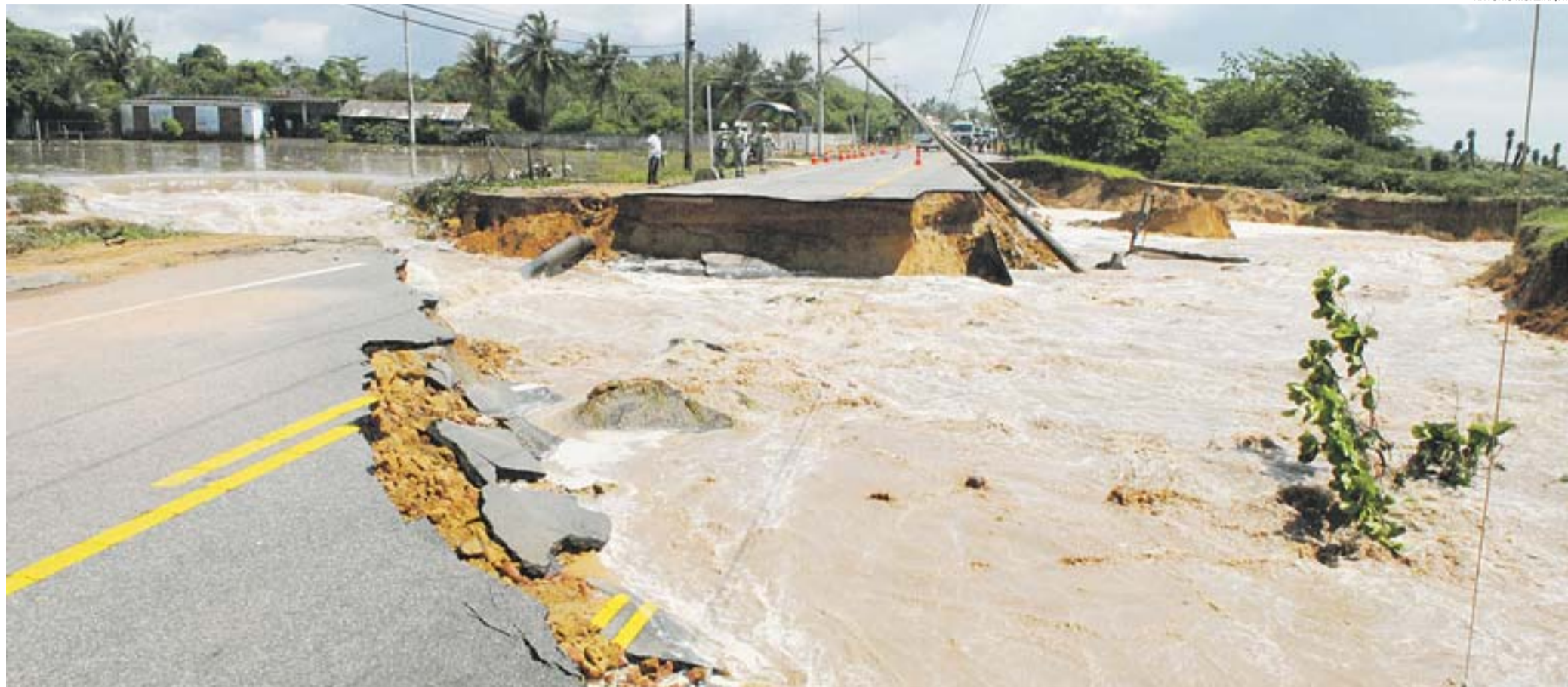
RODOVIA ES-010 , que liga Jacaraípe a Nova Almeida, na Serra, foi totalmente interditada ontem. As águas abriram uma cratera que, segundo o DER-ES, tem entre 30 a 40 metros de extensão
