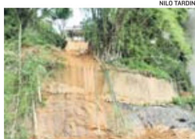
DESABAMENTO em Colatina
