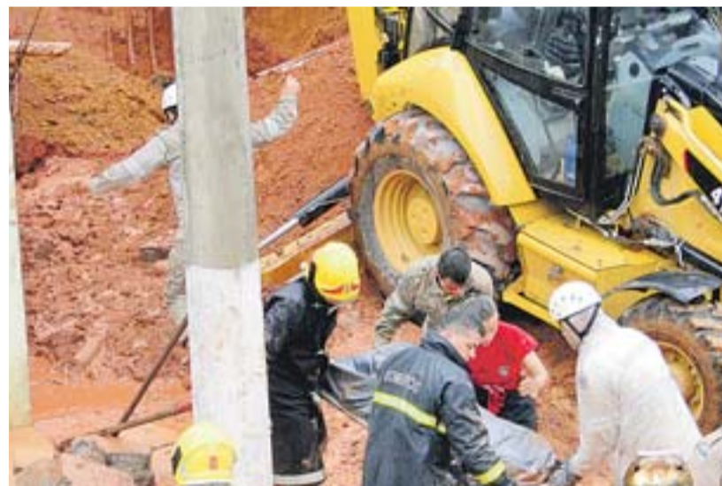
BOMBEIROS retiram o corpo de Julio César dos escombros, em Paraju
