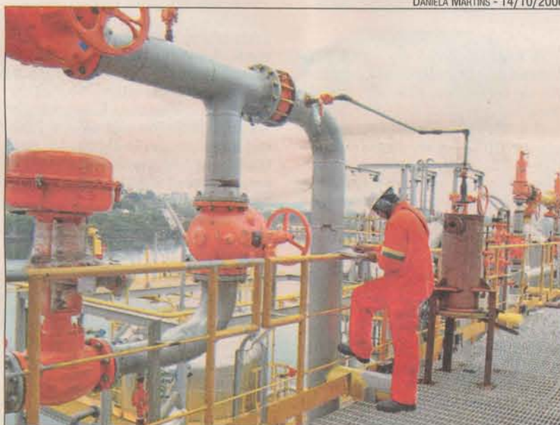
Sistema de tubos da plataforma P-34: 60 mil barris/dia de óleo
