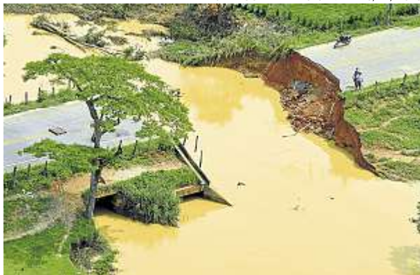
Ponte foi destruída em rodovia de acesso a Pancas
