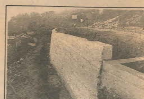
Contenção de encostas necessária
