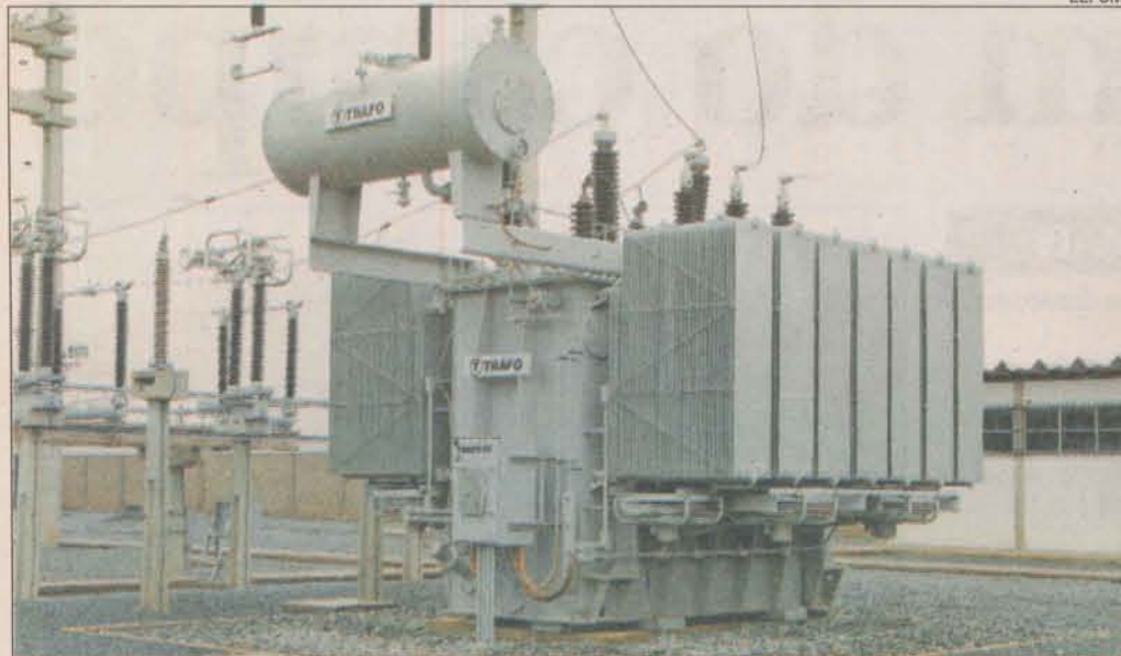
A subestação Henrique Coutinho entrou em operação em dezembro
