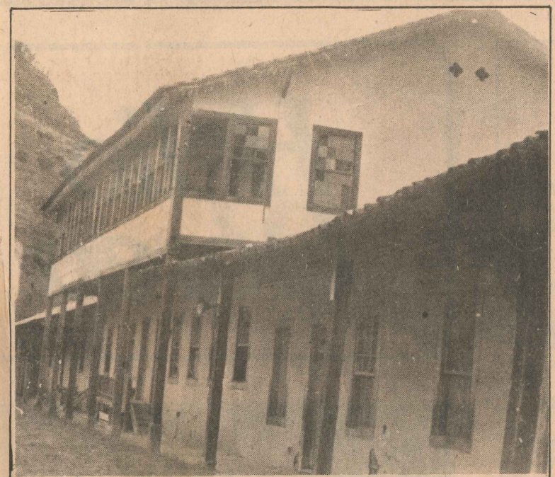
As paredes estão rachadas em vários pontos e a madeira começa a apodrecer
