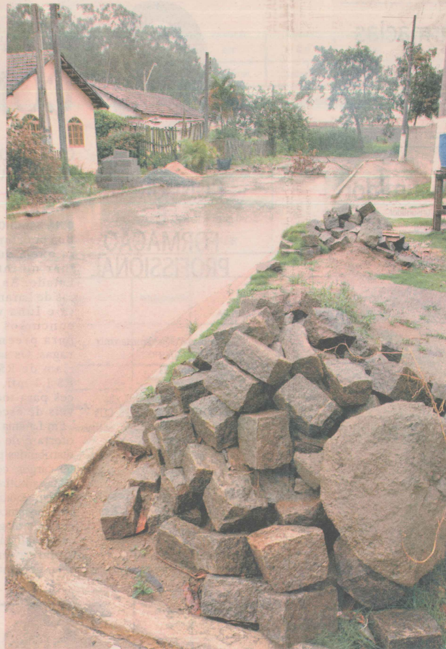
EM CONJUNTO. Moradores querem que os serviços de esgotamento sanitário e de pavimentação, previstos para serem feitos, aconteçam de uma só vez. FOTO: GABRIEL LORDÉLLO
