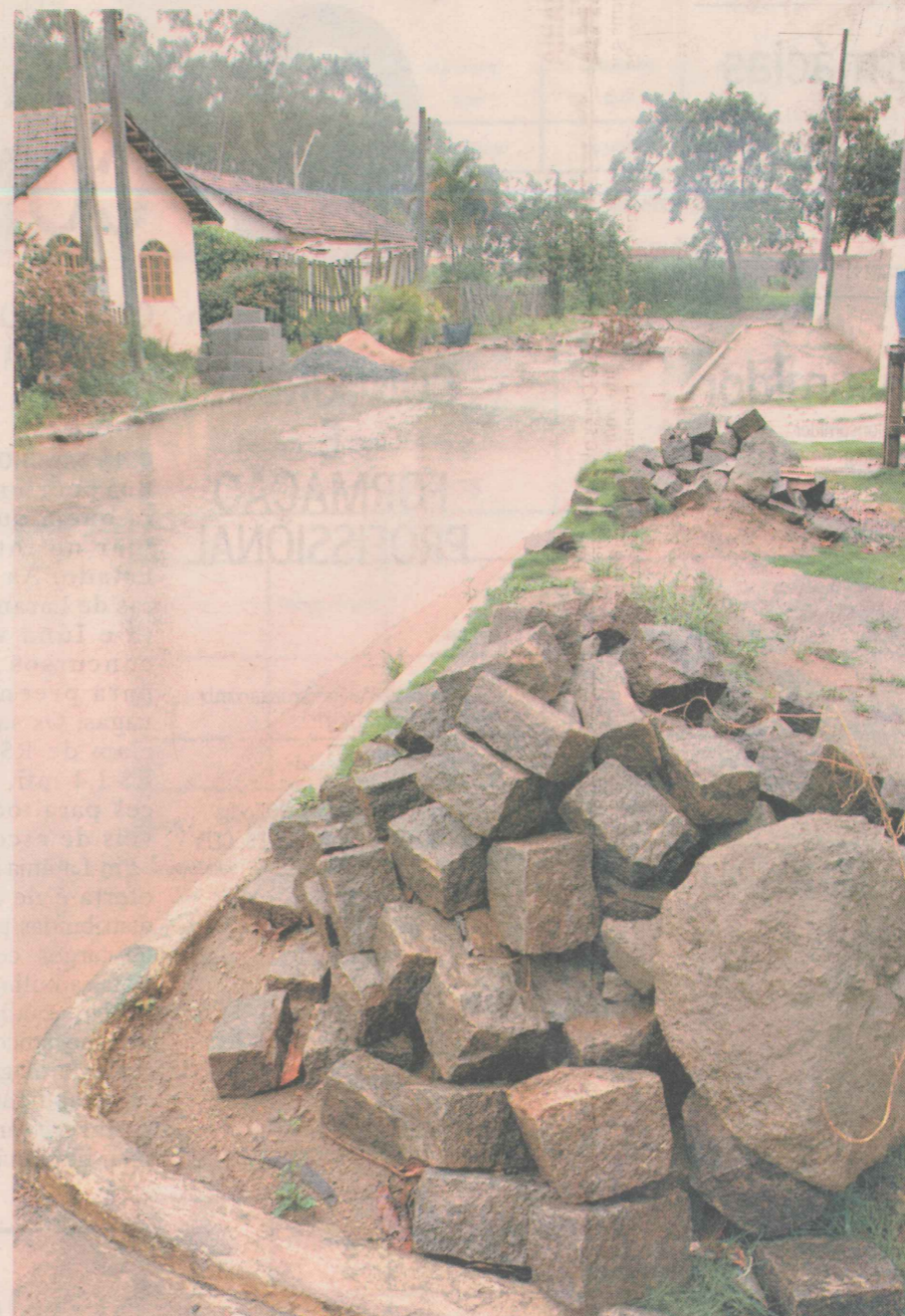
EM CONJUNTO. Moradores querem que os serviços de esgotamento sanitário e de pavimentação, previstos para serem feitos, aconteçam de uma só vez. FOTO: GABRIEL LORDÉLLO
