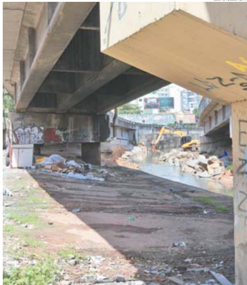
VIADUTO na avenida São Paulo, onde moradores de rua têm se abrigado
