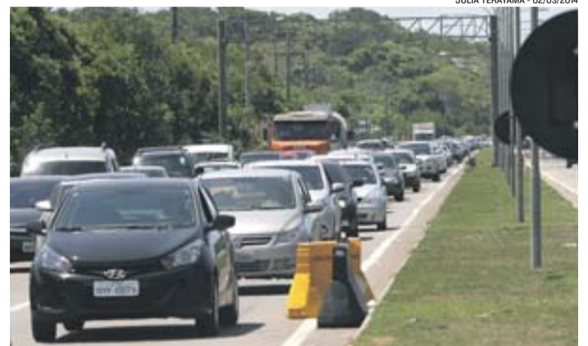
TRECHO DA RODOVIA DO SOL: pavimentação foi inferior à contratada
