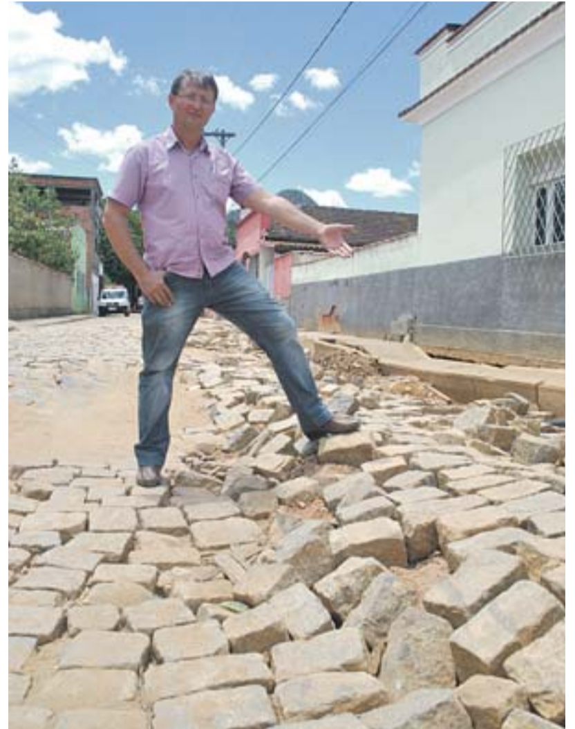
LEOMAR mostra calçamento destruído pelas chuvas no centro de Itaguaçu
