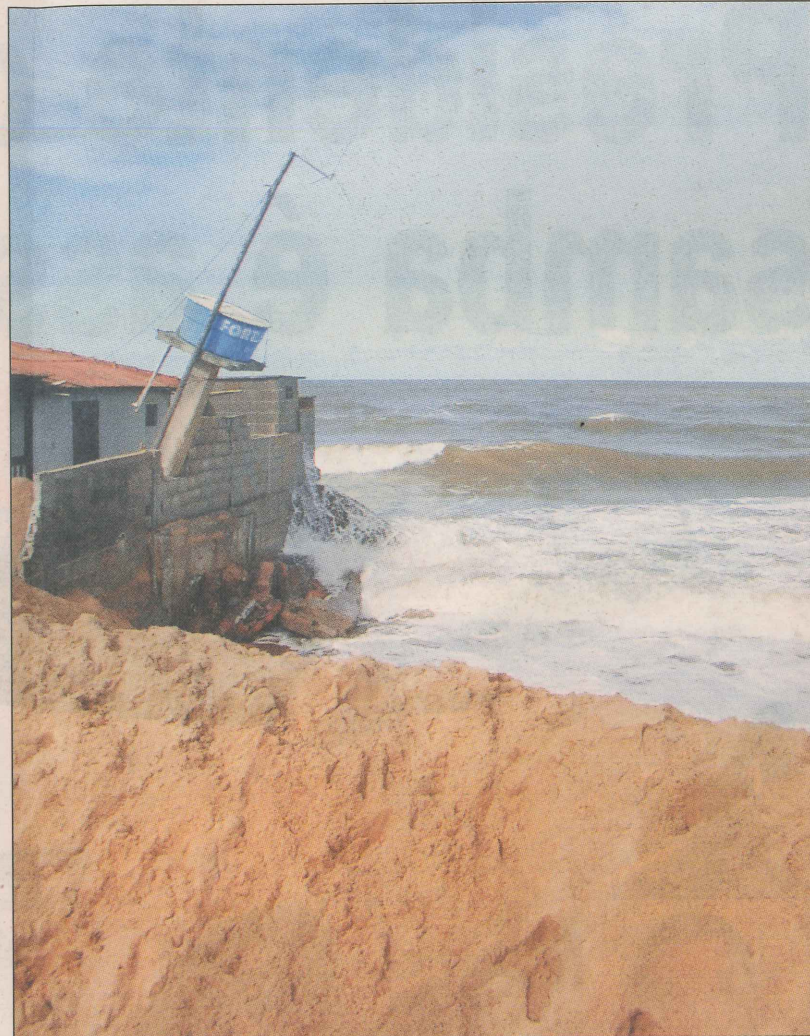
Ação do mar atingiu casas em Conceição da Barra
