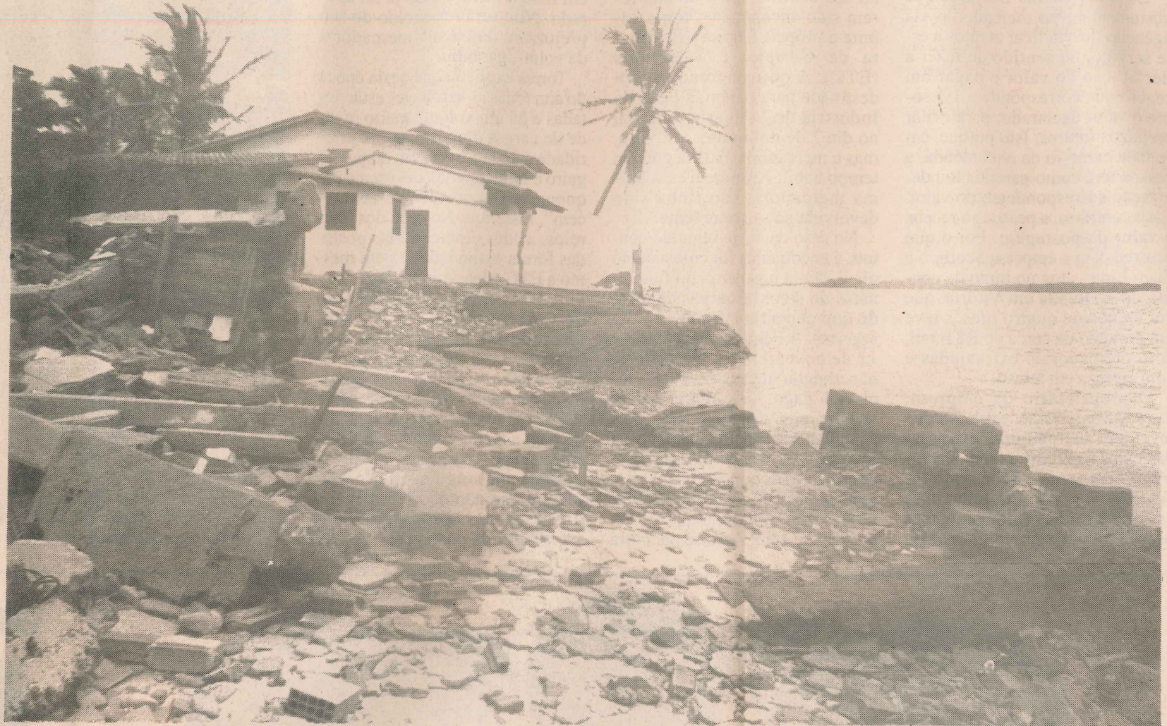
Apesar de barreiras feitas pelos próprios moradores, a maré já destruiu várias casas no Bairro da Bugia e pode acabar com o restante em março
