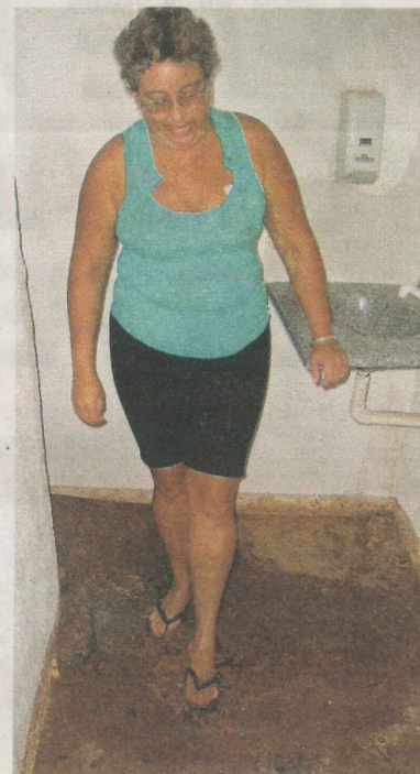
ILMA: banheiro com água e areia
