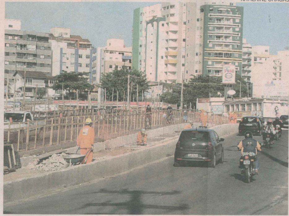
A reforma da Ponte do Canal de Guarapari deve ser concluída até dezembro
