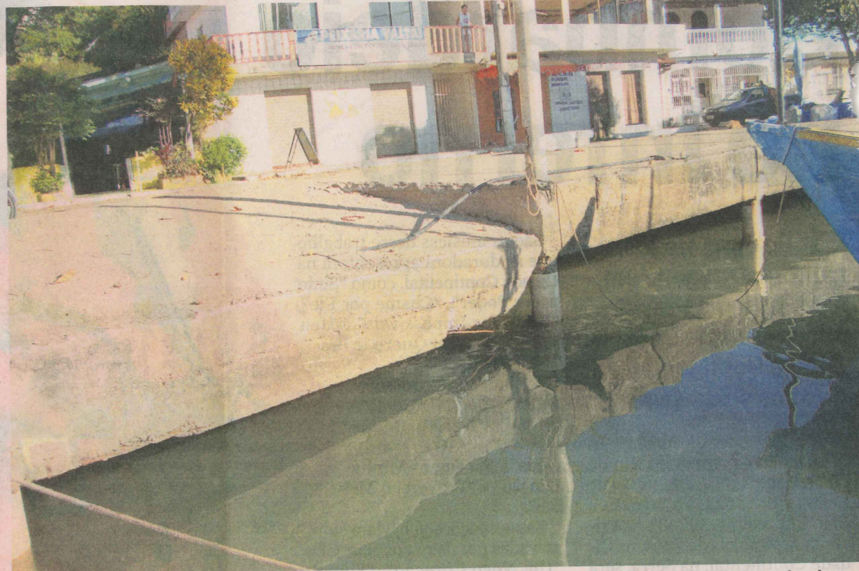
CAIS DO PORTO DE PEROCÃO foi condenado pela Defesa Civil desde o ano passado. Estrutura ameaça desabar
