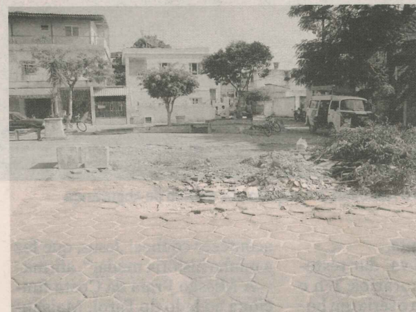
ENTULHO no meio da praça do bairro Aeroporto
