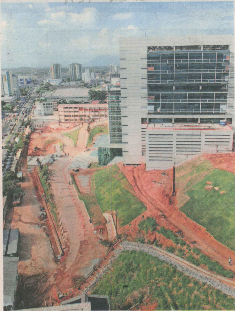
NOVA SEDE da Petrobras: área construída é o dobro da planejada em 2005
