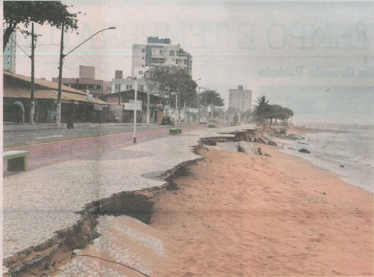
TRECHO do calçadão da praia de Jacaraípe que foi destruído pelas fortes ondas da última semana: erosão
