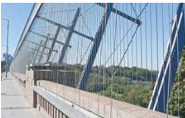
NA PONTE PRINCE EDWARD, em Toronto, Canadá, uma série de grades previnem contra suicídios.
