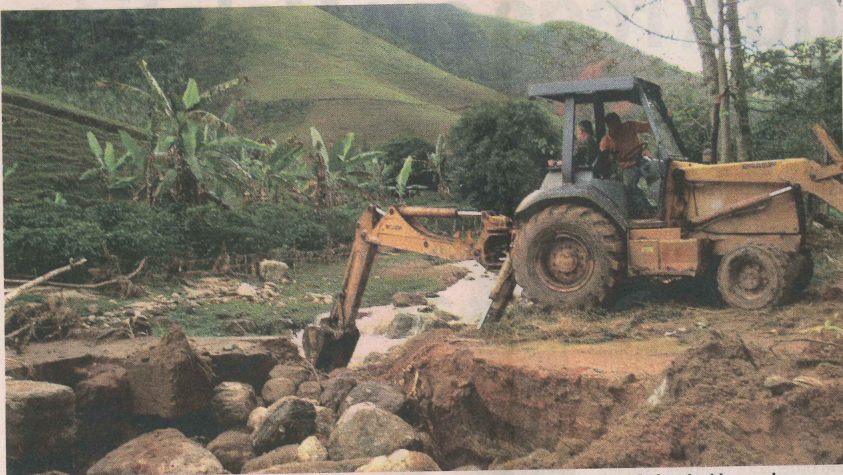
MÁQUINA da Prefeitura de Iconha retira pedras e restos de ponte em córrego de localidade atingida por chuva
