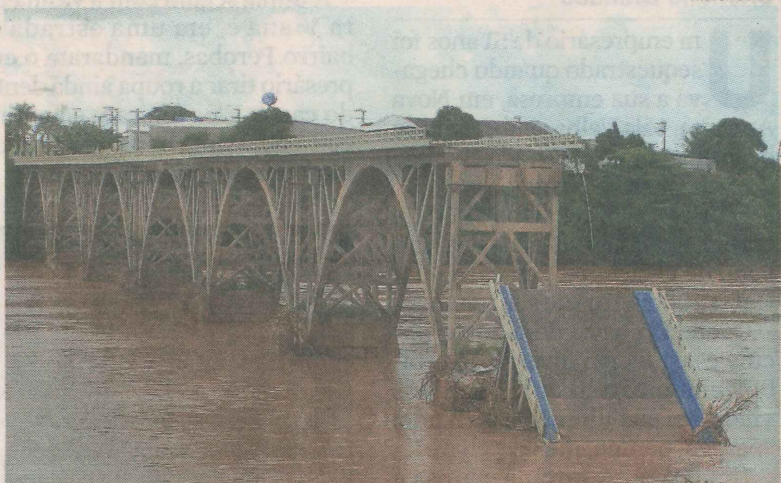
PONTE Getúlio Vargas: queda de parte da estrutura matou uma mulher
