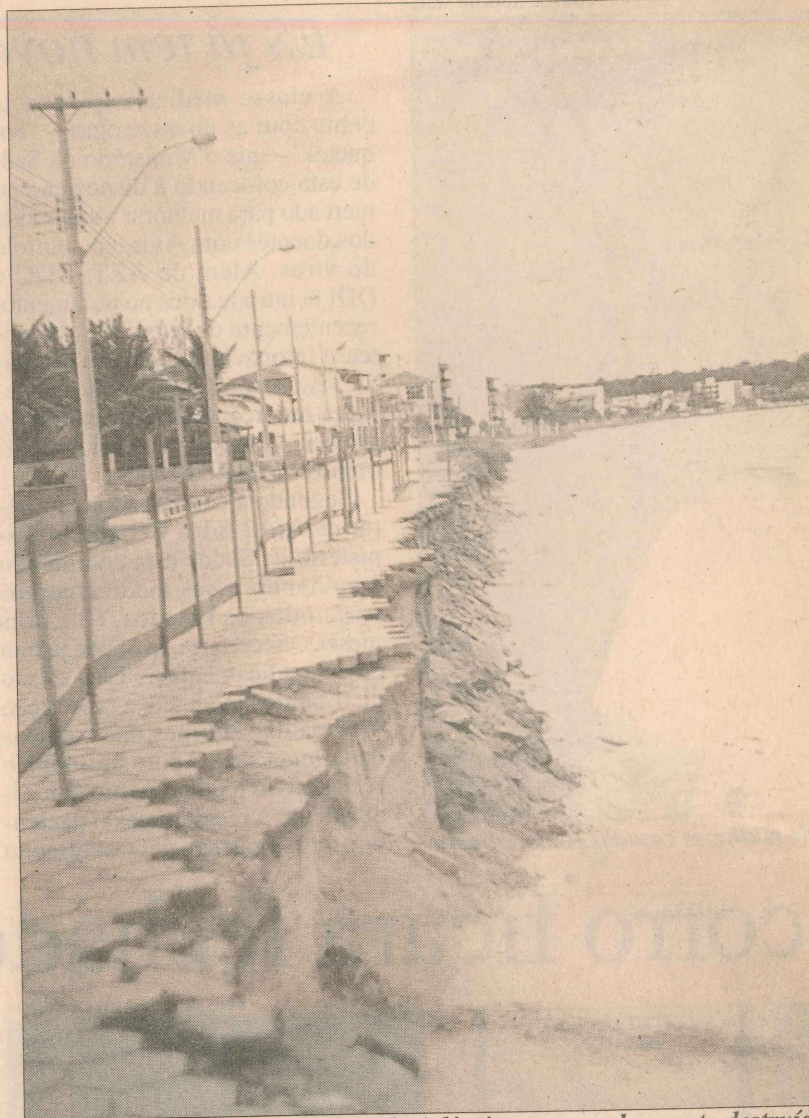
Mais de um quilômetro da Avenida Atlântica teve o calçamento destruído
