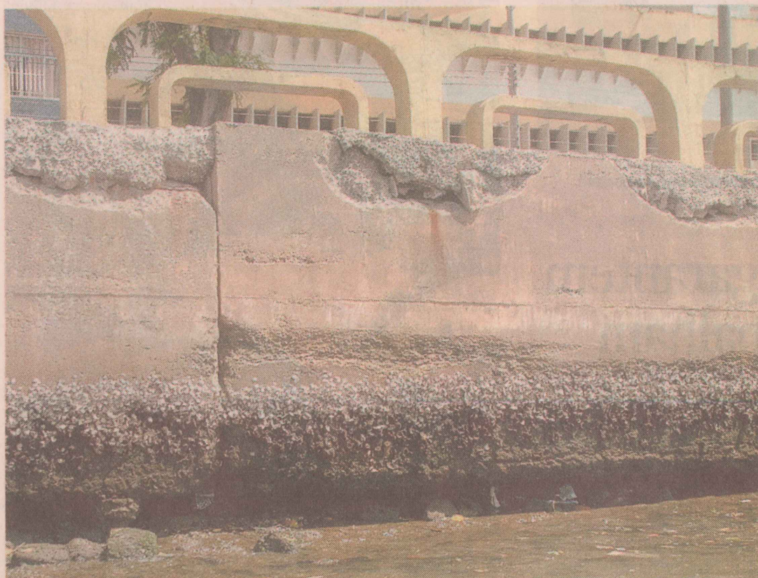
DE FRENTE PARA O MAR. O muro de contenção sofreu um processo de erosão e terá que ser totalmente reformado. Situação surpreendeu técnicos que fizeram a vistoria. FOTO: DIVULGAÇÃO
