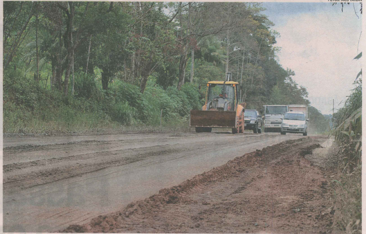
TRECHO DA ES-261 que era asfaltado e virou estrada de chão depois de recortes: queda no movimento de turistas
