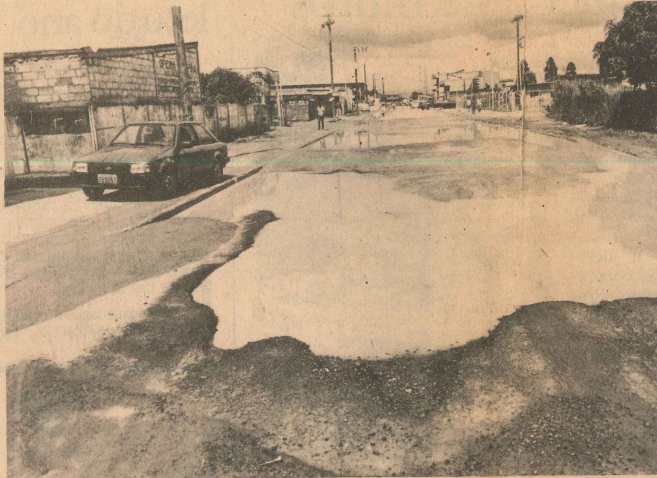
A principal rua do bairro fica alagada com qualquer chuva
