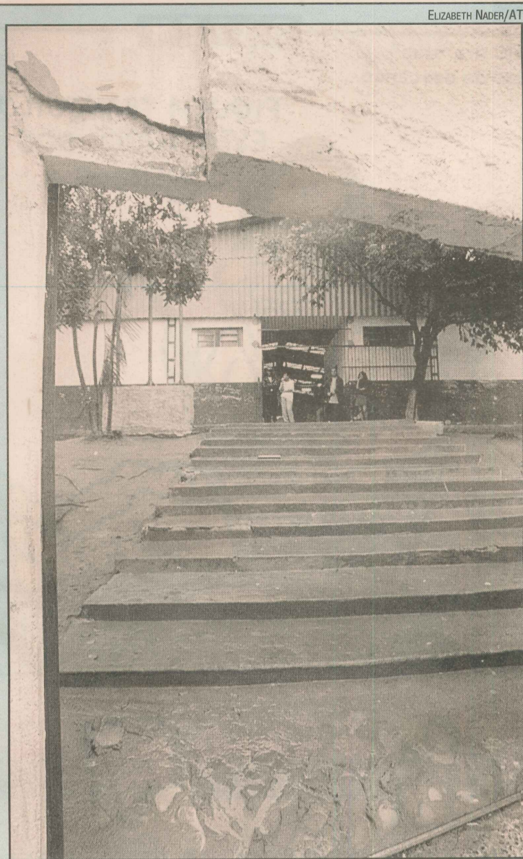
No colégio Manoel Carlos Miranda, condições precárias
