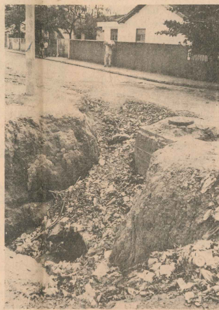
Na rua Cedro, os efeitos da erosão
