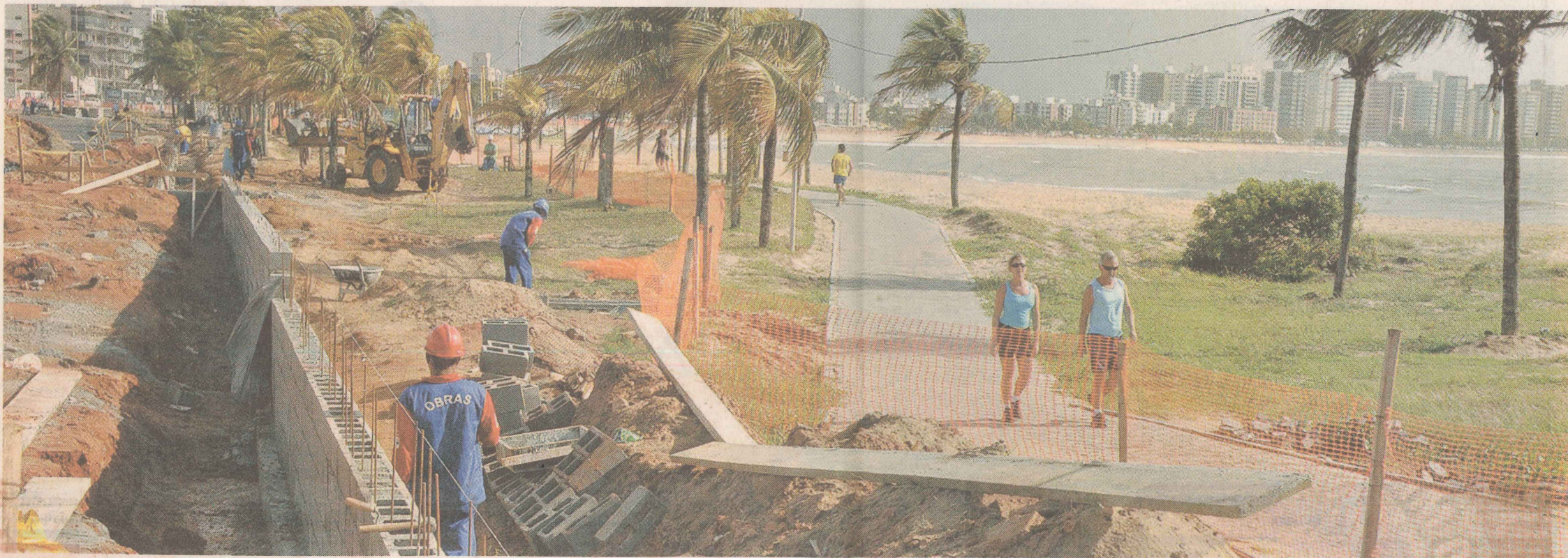
CANTEIRO. As obras de recuperação na orla de Camburi, em Vitória, não vão dar trégua ao turista, que precisará de paciência durante a temporada. FOTO: GILDO LOYOLA
